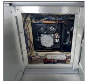
A5. Vano condensatore
