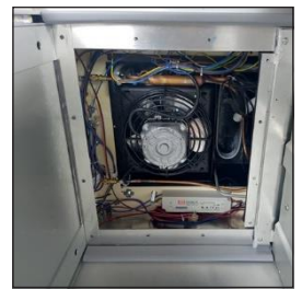
A5. Compartimento del condensador
